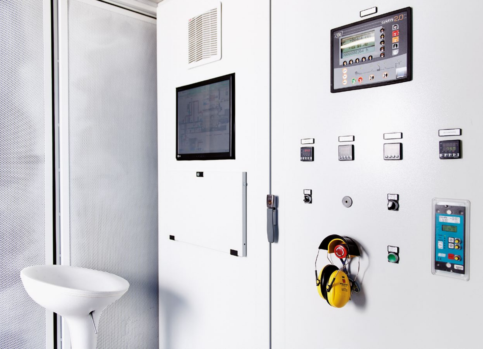
Quadro di Comando impianto di Cogenerazione
